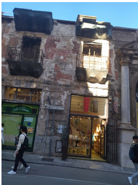
Рис. 3. Развалины на улице Кассаро, Палермо. Февраль 2025 г. Фото О.Д. Фаис-Леутской
